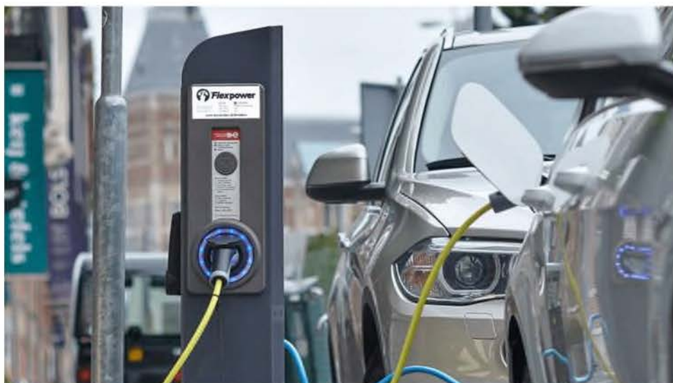
Obr. 14 - Pohled na dobíjecí stanici „Flexpower“ 62
